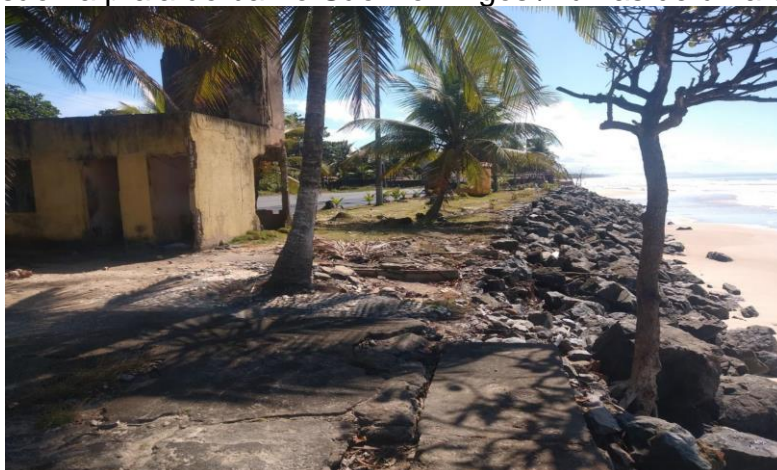
Figura 02. Erosão na praia do bairro São Domingos / ruínas de uma cabana.
