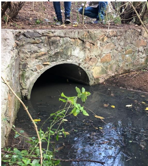
Figura 2. Descarga de efluente no Açude do Gravatá, município de Serrinha-BA.
