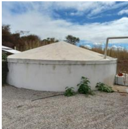
Figura 1: Cisterna de armazenamento.
