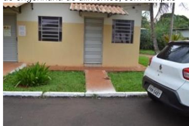
Figura 2 - Bloco de Salas de aula no pavilhão de engenharia de alimentos, sem rampas
